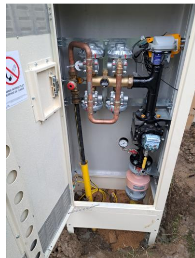
Exemple : poste atypique
